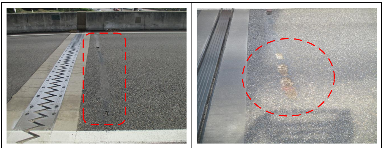
【사진 3.22】 교면포장 보수부 재손상(패임) 현황
