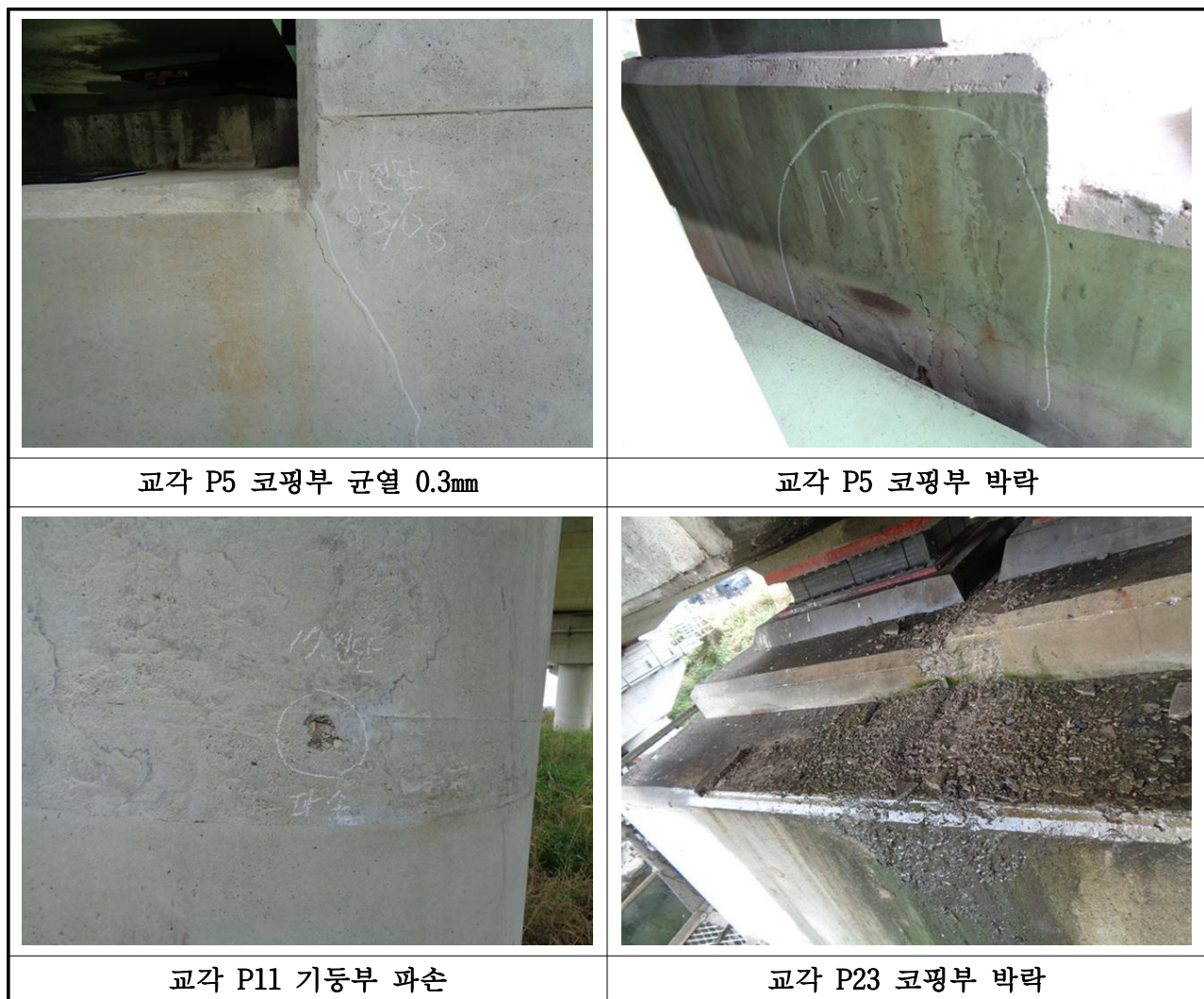
【사진 3.14】 교각 손상현황
