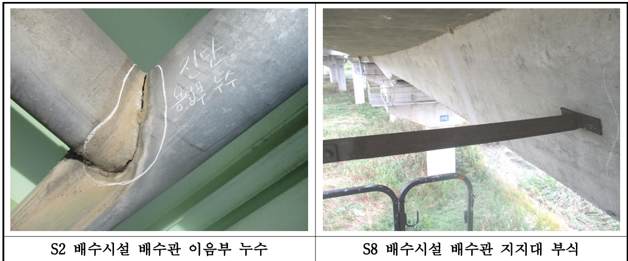
【사진 3.24】 배수시설 손상현황
