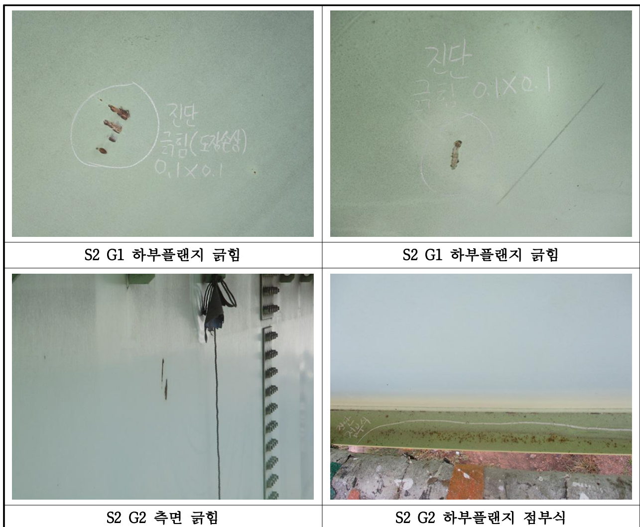
【사진 3.8】 강박스 거더 외부 손상현황
