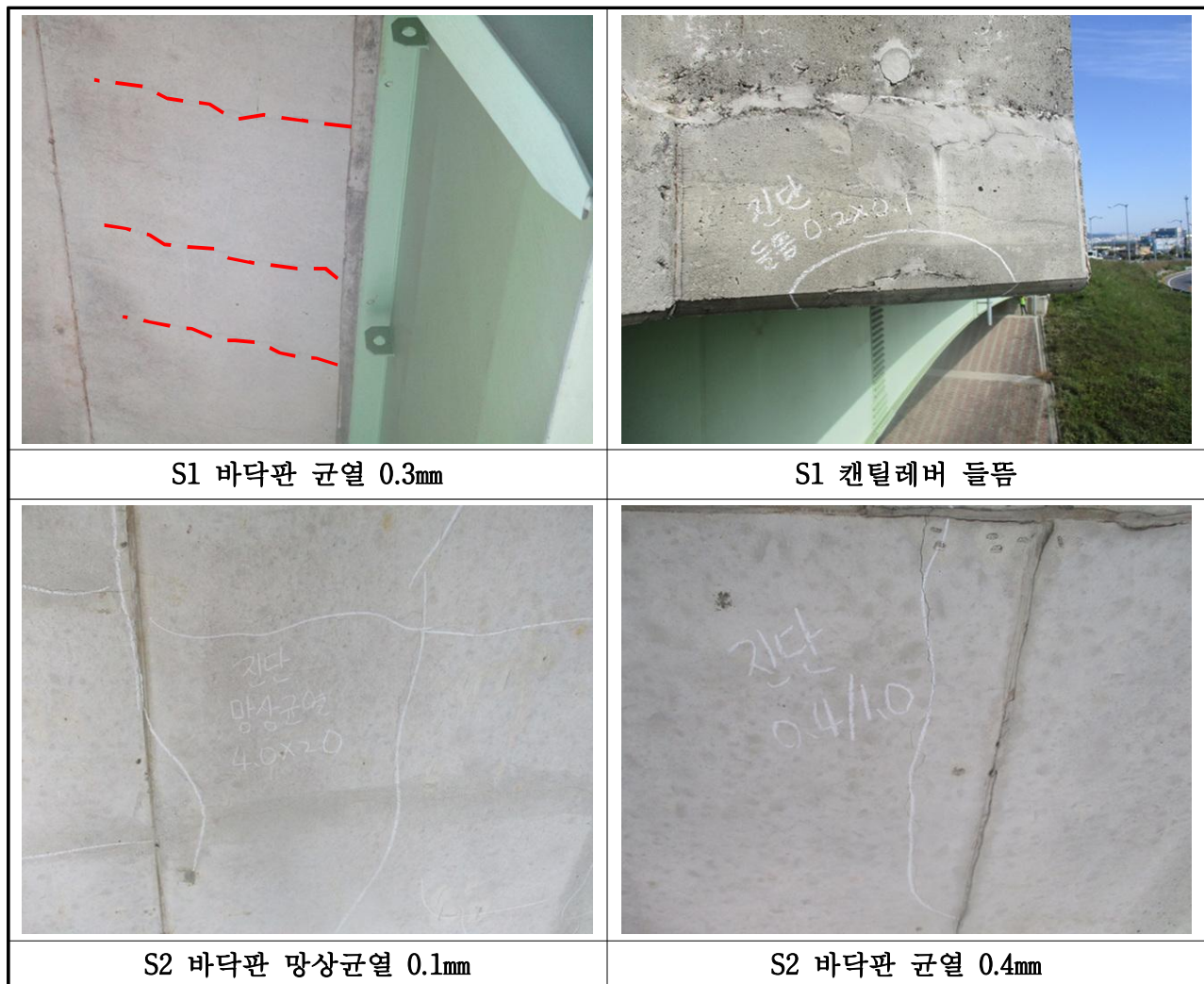
【사진 3.3】 바닥판 손상현황
