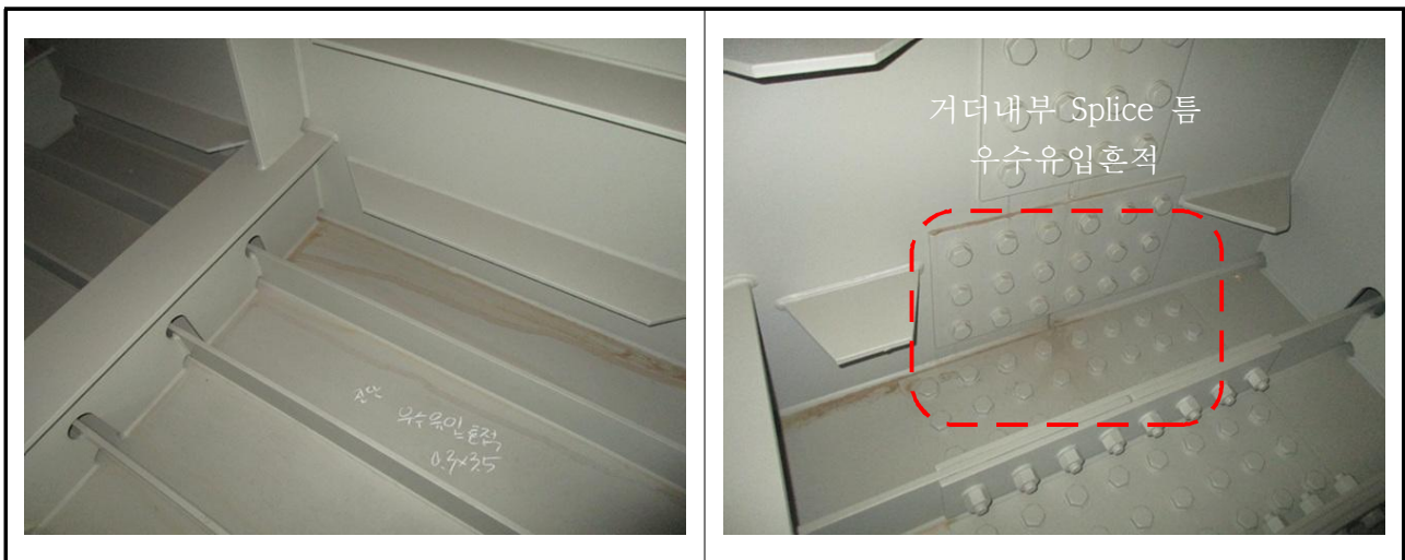
【사진 3.7】 강박스 거더 내부 Splice부 우수유입흔적
